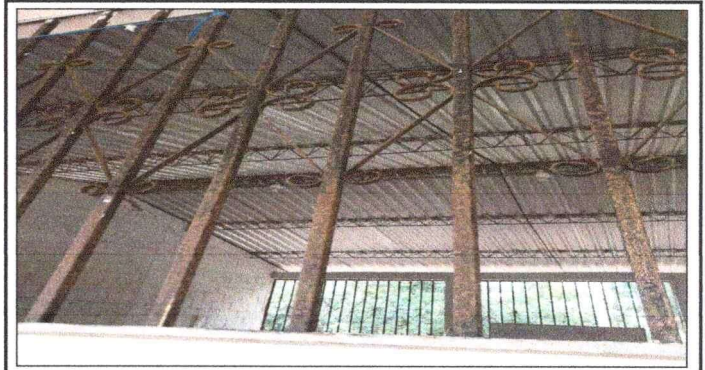
Foto 4: AULAS: Ya es necesario lijar y pintar los balcones..
