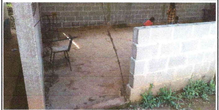
Foto 2: COCINA: Faltan puertas, ventanas y piso.
