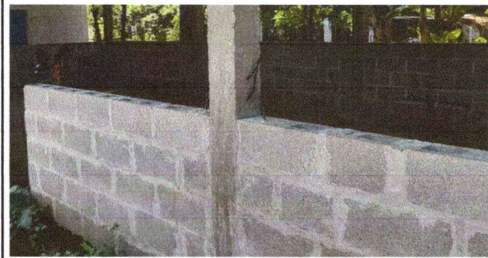
Foto 3: COCINA: Hace falta repello.
